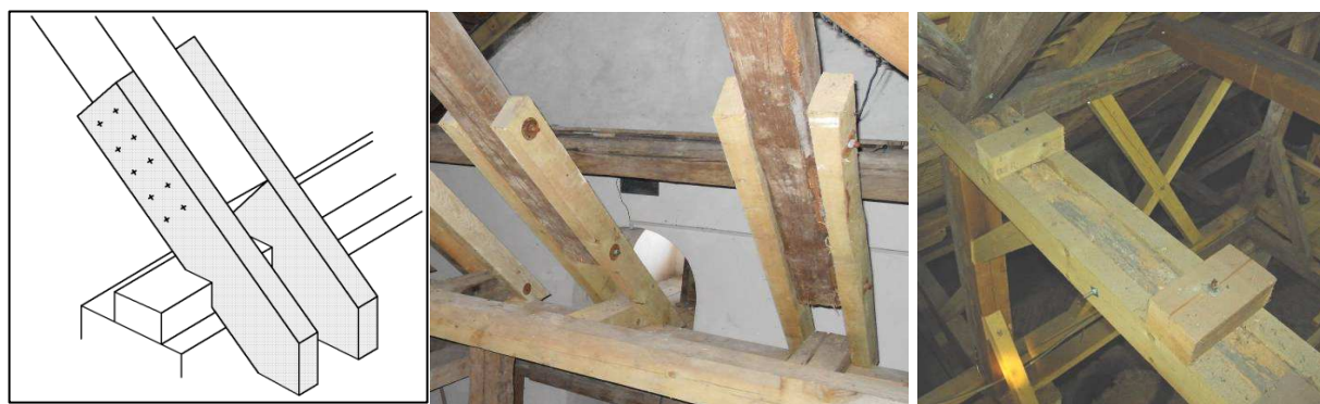
Obr. 4 Vľavo a v strede nahradenie poškodenej časti krokvy. Vpravo spevnenie hambálka obojstrannými drevenými príložkami v snahe zachovať čo najväčšie množstvo autentického materiálu –Walterskirchen (Rakúsko). Foto Peter Krušínský
